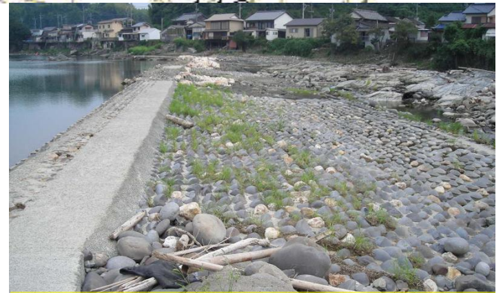
堰は左岸に近い場所で数10mにわたって破壊され、河床には流木が多く残された。
