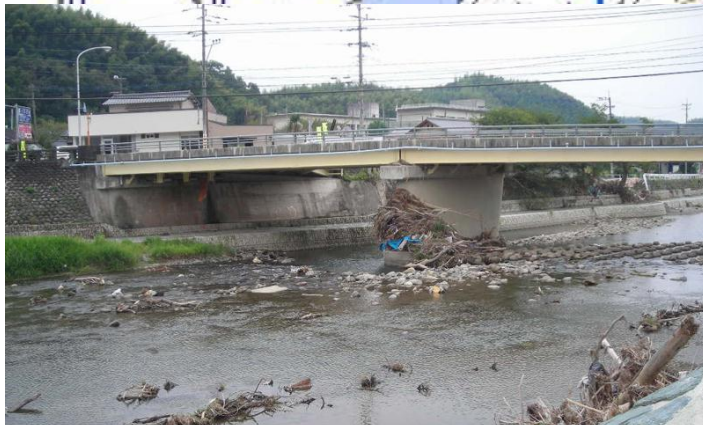
山内橋では橋桁直下部にトラッシュが付着している。
