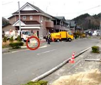
図7 鷹ノ巣東3丁目 :抜け上がり 右手下は陥没
