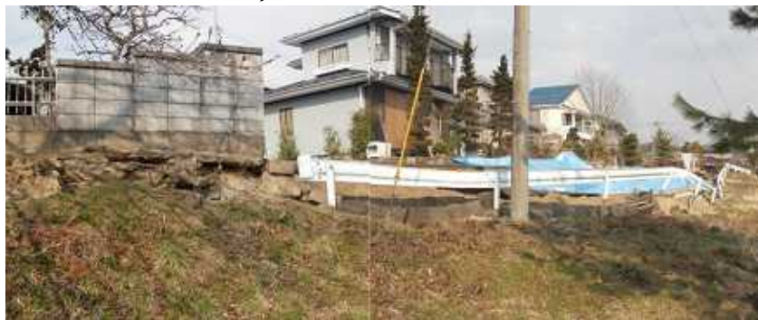
図3 緑ヶ丘1丁目12(谷頭部の盛り土)の地すべり
