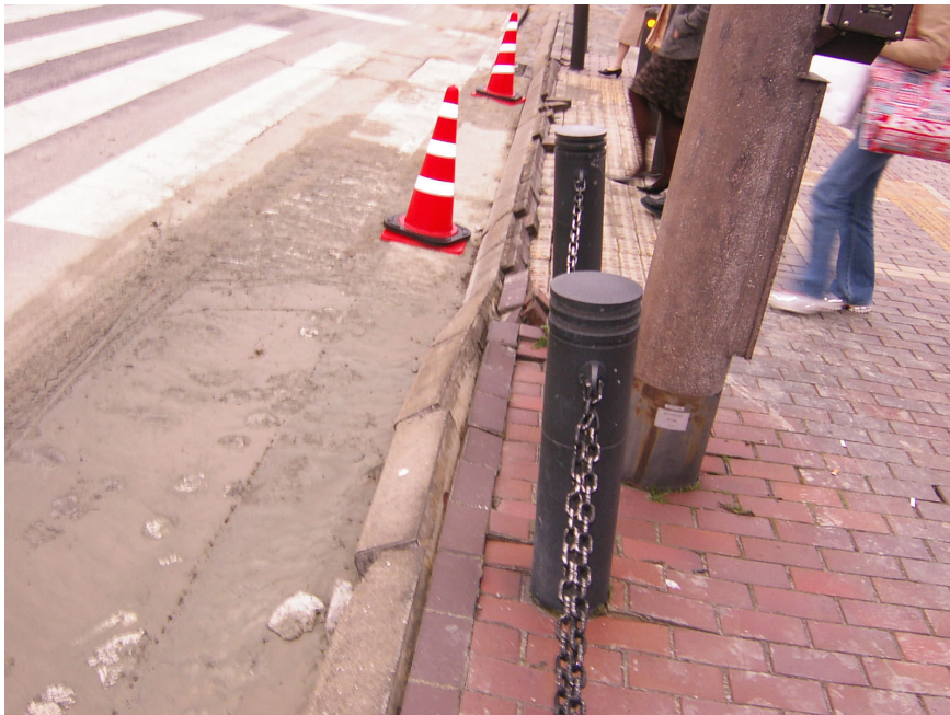
福岡市早良区百道浜；南側縁石が壊れ歩道の柵が傾いている。（3月20日磯撮影） 写真の垂直に見える柵は傾いています。
